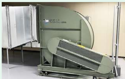
インバーター制御化した空調設備の循環ファン
