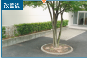
改善前 改善後 地上にせり出していた木の根につまずく危険があったため、根をアスファルトで埋めました。
