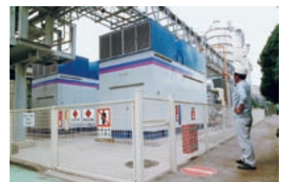
東京工場でコ・ジェネレーション・システム導入
