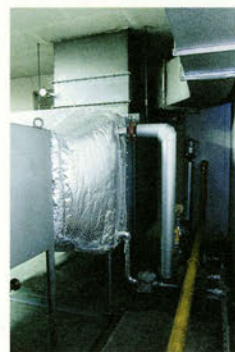
蒸気ダクト 燃焼部へ供給される蒸気配管
