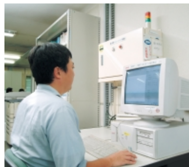
南陽工場 電力管理システム
