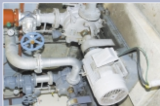
▲工業用水の使用状況（水圧）に応じて給水ポンプモーターの回転数をコントロール
