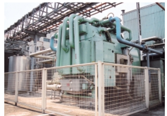
東京工場 CGS排熱利用吸着式冷凍機
