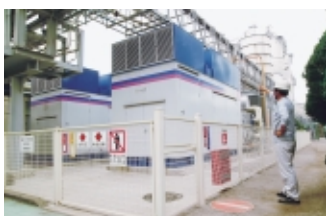
東京工場でCO 2 ジェネレーション・システム導入
