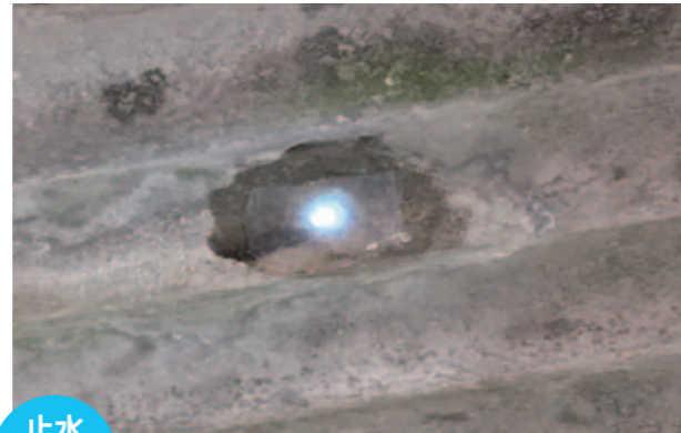
止水 Water stop スレート屋根の漏水補修 Slate roof water leakage repair
